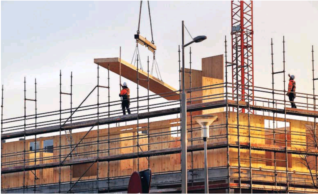
Promoción de 65 viviendas protegidas en Hondarribia (Guipuzkoa) con estructura de madera que realiza la empresa vasca Egoín.
